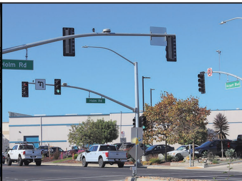
El nuevo semáforo con cruces peatonales en Holm Rd. y Airport Blvd. protege a peatones y conductores.
